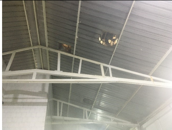
Foto No. 5 sistemas de ventilación
